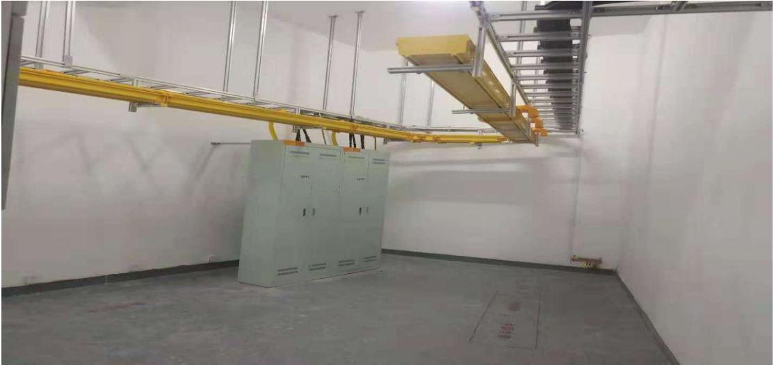
附图 10：电信间桥架、尾纤槽、机柜建设场景图
