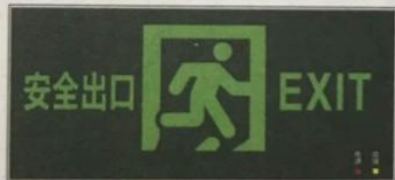
图 3.5-7 安全出口标志灯
