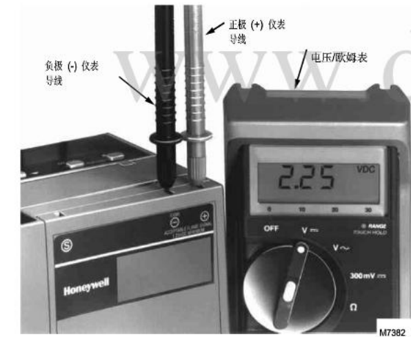
图11. 测量7800系列控制器火焰信号电压值
