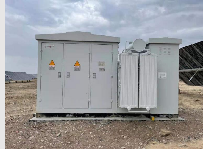
图：云路自主研发3150kVA非晶箱变光伏发电用组合式变压器
